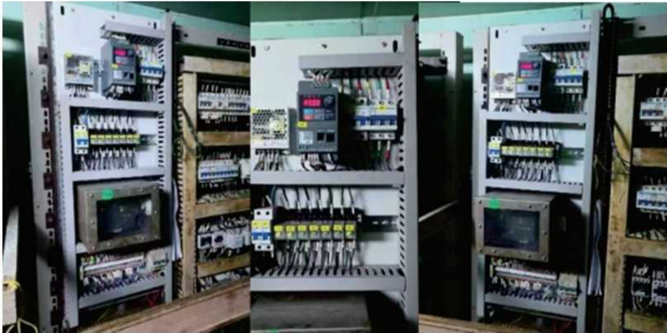
物料小车控制系统现场应用
